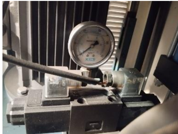
Gambar 2. Katup kontrol (control valve) pada sistem hidrolik
