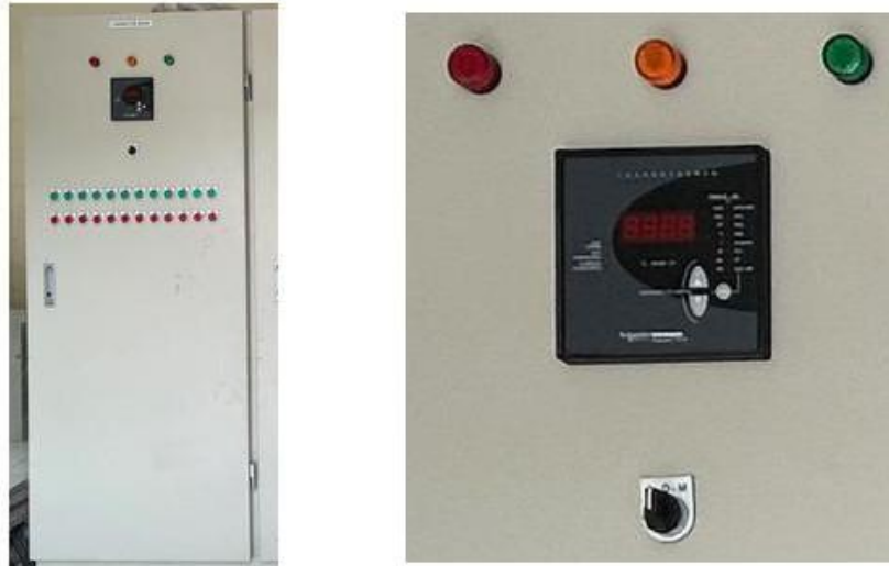
Gambar 4. Panel capacitor bank 300 kVAR (12 step @25 kVAR) dan indikator power factor (PF) pada LVMDP
