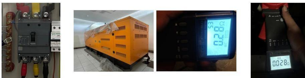
Gambar 3. Kabel dan pengaman SDP Distribusi Pompa, unit generator set, hasil pengukuran grounding LVMDP (0,28 Ω), dan grounding SDP Distribusi (0,028 Ω)
