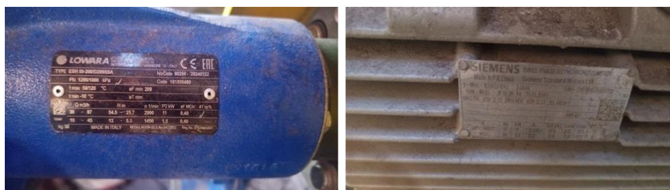
Gambar 1. Data nameplate pompa sentrifugal dan motor penggerak
