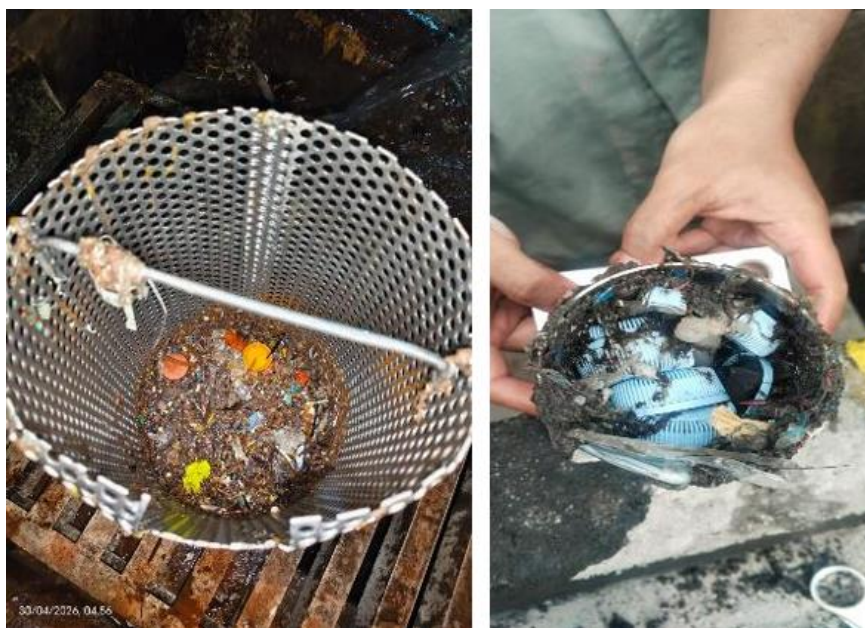
Gambar 4. Kondisi strainer tersumbat material asing
