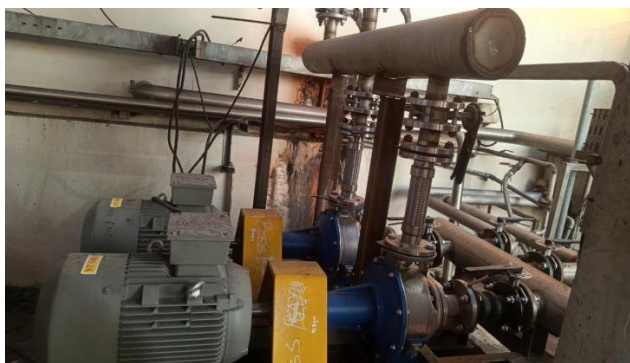
Gambar 3. Instalasi pompa sentrifugal pada area plant
