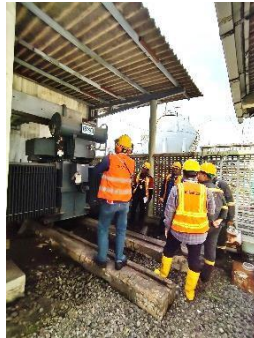
Gambar 11. Foto lingkungan sekitar Transformator 5-2
