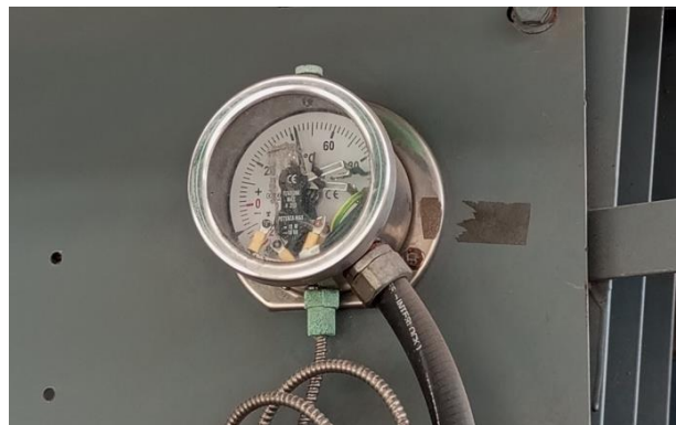
Gambar 4. Foto Winding Temperatur Indicator yang berada di OTI
