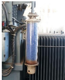
Gambar 12. Foto silica gel Transformator TR 5-2 kondisi normal
