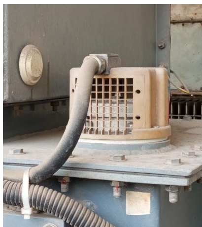
Gambar 5. Foto Sudden Pressure Relay yang ada di atas tangki transformator
