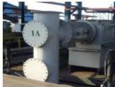
Gambar 8 Trafo Rectifier(T/R) Set
