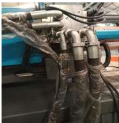
Gambar 6. Pipa di Mesin Injection Moulding
