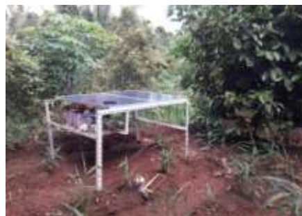
Gambar 8 Pembangkit Listrik Energi Matahari.
